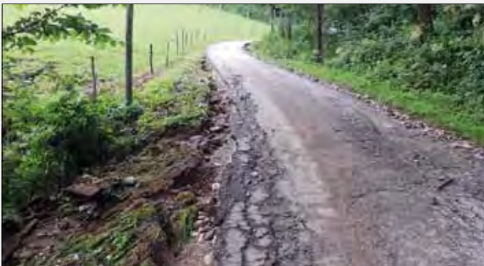
Findenig Straße nach dem Unwetter
